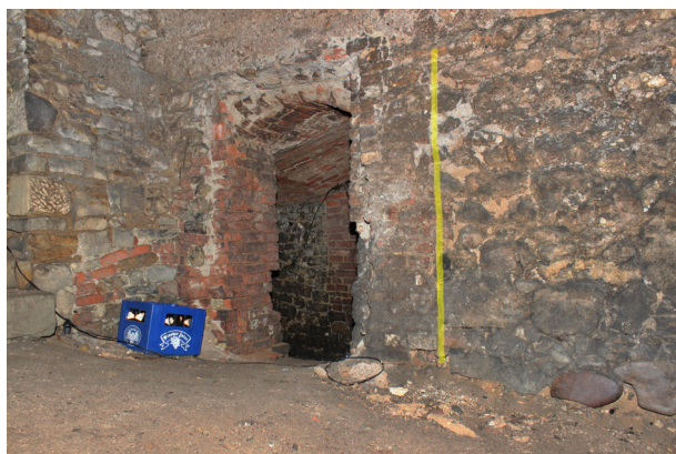
S.02_03. Západní stěna, vpravo žlutou čarou vyznačena spára mezi cihelným a kamenným zdivem (S.02_C), pohled od severovýchodu.
