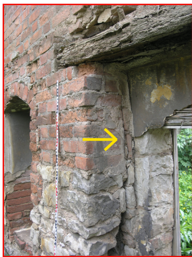
P.07_04. Jižní stěna, spára mezi špaletou niky a ostěním otvoru (P.07_A), pohled od severozápadu.
