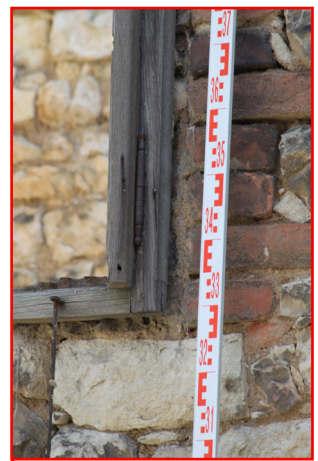
1.05_13. Západní stěna, okenní otvor O 12 1.05_01, detail závěsu, pohled z exteriéru od jihovýchodu.
