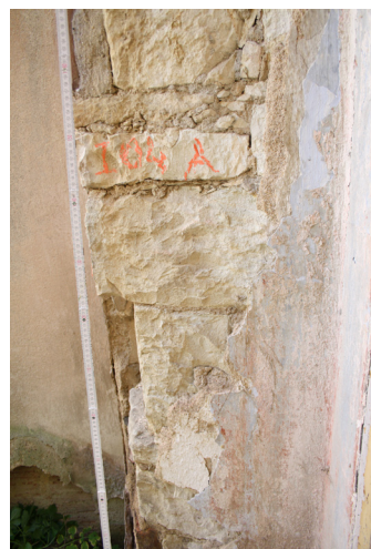
1.04_03. Jižní stěna, okenní otvor O_{10} 1.04_01, východní špaleta s náleзовou situací 1.04_A, pohled od severozápadu.
