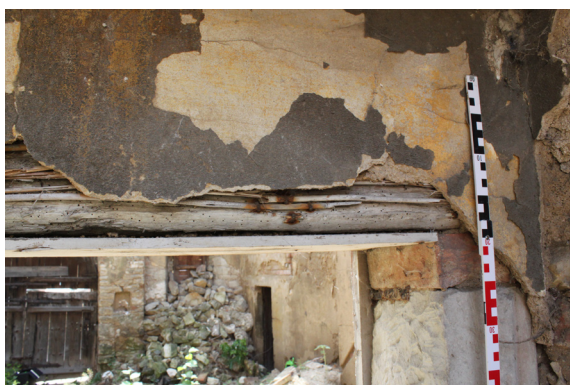
P.01_42. Severní stěna, dveře D 2 P.01_01, detail omítek na rubové straně trámového překladu otvoru, pohled od severovýchodu.
