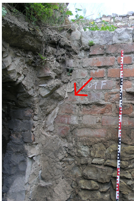
P.01_24. Portál P 2 102_01, zabíhající omítka pod maltu, ve které byla upevněna stojka portálu situace P.01_F, pohled od jihu.
