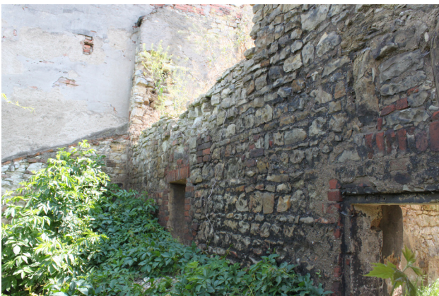
E.04_08. Severní průčelí severního traktu, východní osa se zříceným zdívkem patra, pohled od severozápadu.
