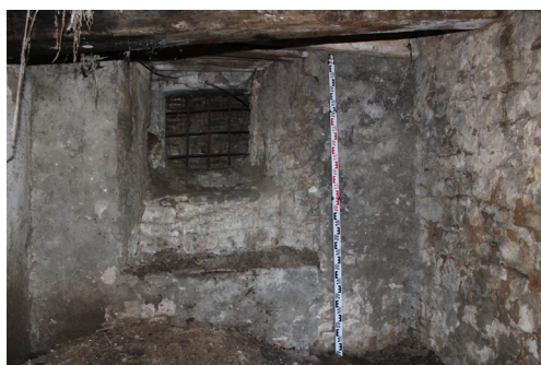
P.03_02. Jižní stěna, západní polovina s oknem O 4 P.03_01, pohled od severu.
