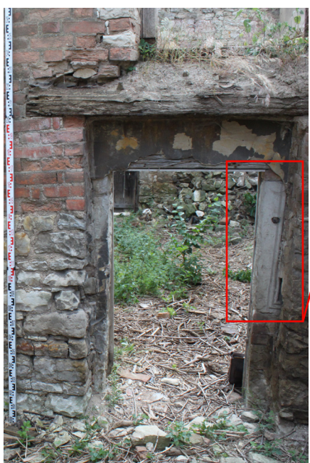
P.01_37. Severní stěna, dveře D 2 P.01_01, trámové překlady špalety a otvoru při pohledu od severu.
