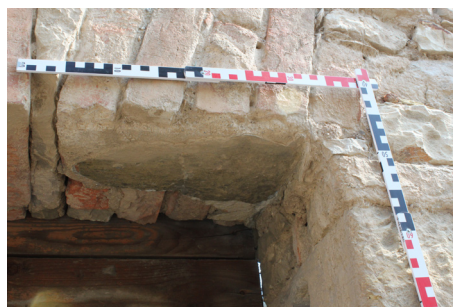
E.01_13. Jižní průčelí jižního traktu, okenní otvor O 1 P.01_01, detail dochované omítky, pohled od jihu.
