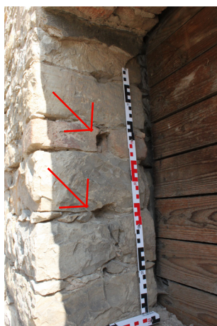
E.01_11. Jižní průčelí jižního traktu, okenní otvor O 1 P.01_01, detail kapes po mříži v západním ostění, pohled od jihovýchodu.
