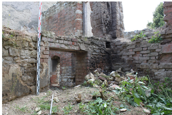
P.06_13. Východní stěna, jižní část se vstupním otvorem D 4 P.06_01, pohled od severozápadu.
