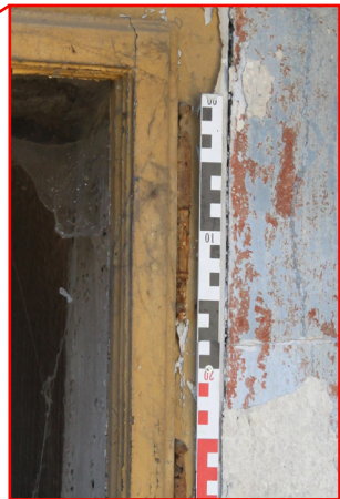
1.03_10. Jižní stěna, okenní otvor O 10 1.03_01, detail závěsu horních křídel, pohled od severu.
