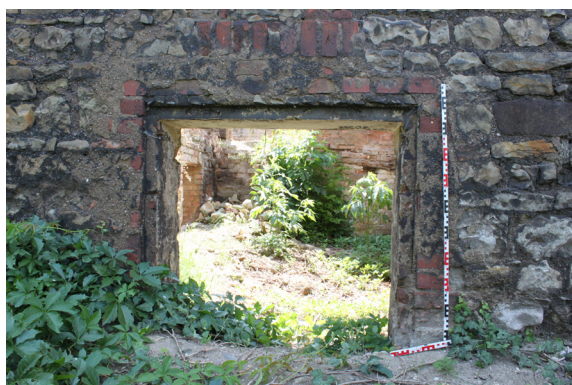
P.06_11. Severní stěna, detail rubové strany okenního otvoru O 7 P.06_01, pohled od severu.
