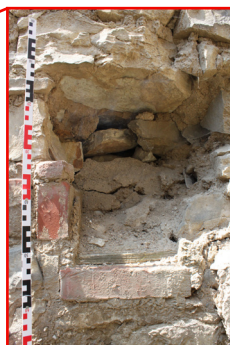
P.06_08. Západní stěna, detail kapsy po stropních trámu (P.06_C), pohled od východu.
