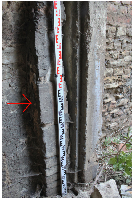
P.01_29. Portál P 2 102_01, severní stojka, detail vnitřní polodrážky, šipkou označena druhotně použitá stojka z portálu P 3 P.04_01, pohled od jihozápadu.
