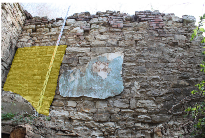
1.05_19. Východní stěna, severní část, barevně vyznačené zdivo zazděného vstupu do 1.06 (1.05_E), pohled od západu.
