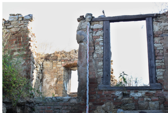
P.01_43. Severní stěna, západní část, vlevo bývalý vstup do 1.06, vpravo do vstupu D 3 P.01_01 do 1.07, pohled od jihu.
