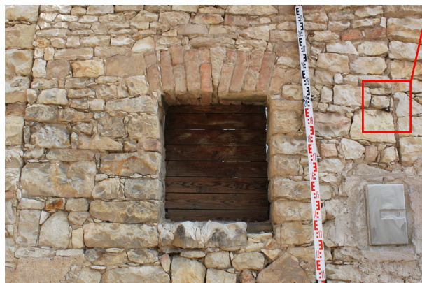
E.01_09. Jižní průčelí jižního traktu, okenní otvor O 1 P.01_01, pohled od jihu.
