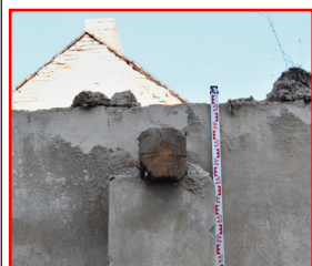
P.01_16. Západní stěna, detail přízedního pilíře se zbytkem průvlaku, pohled od severovýchodu.
