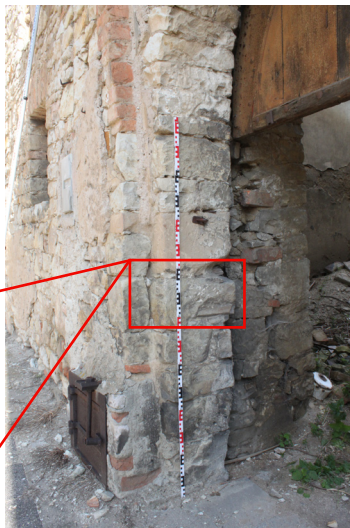
E.01_06. Jižní průčelí jižního traktu, průjezd s vraty V 1 P.01_01, západní stojka, pohled od jihovýchodu.
