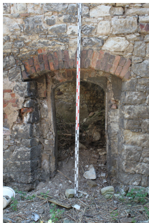
P.05_03. Západní stěna, rubová strana vstupního otvoru D 3 P.05_01, pohled od západu.
