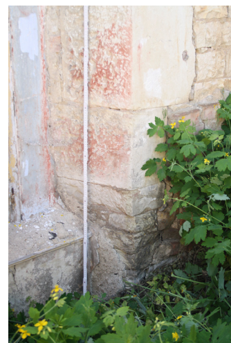
1.04_05. Jižní stěna, okenní otvor O_{10} 1.04_01, západní špaleta s náleзовou situací 1.04_B, pohled od severovýchodu.
