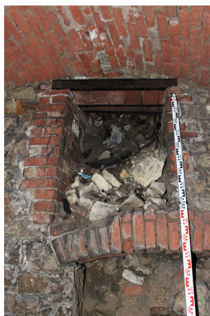
S.05_03. Jižní stěna, větrací okno pod klenbou s cihelnou špaletou a záklenkem ( S.05_A ), pohled od severu.
