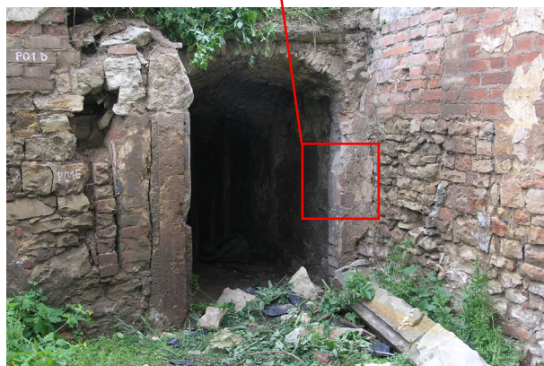
P.01_23. Portál P 2 102_01, stav v roce 2014 po odpadnutí portálové stojky, čímž se odhalila situace P.01_F, pohled od východu.
